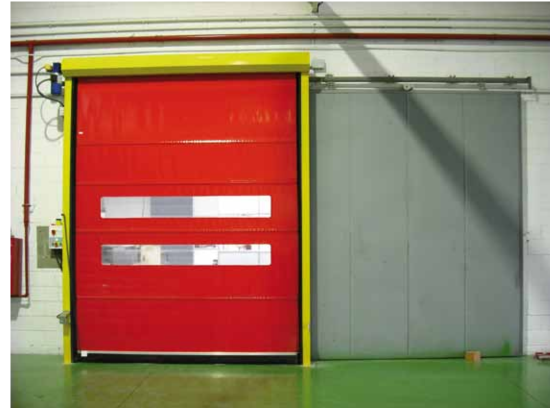
Conjunto puerta cortafuegos con rápida.
